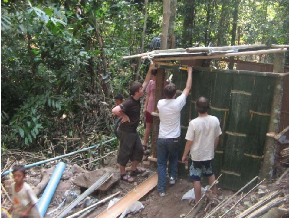
รูปที่ 7: นักเรียนจาก Spring Street high school และอาสาสมัครสตีเฟน สร้างรั้วไม้ไฟสำหรับ powerhouse
