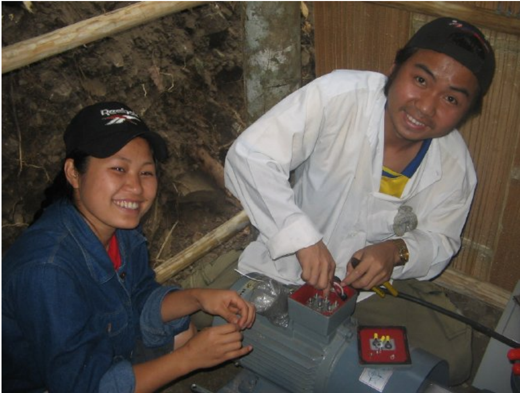
รูปที่ 6: นาย ชันเด และนางสาว จิจี จาก Engineering Study Program ที่ศูนย์พักพิงชั่วคราวบ้านแม่หละ เดินสายไฟในช่องสายไฟของเครื่องผลิตไฟฟ้าสามเฟส ขนาด 400 โวลต์
